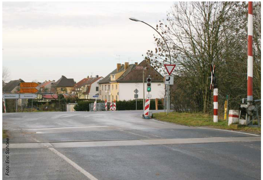
Abbildung 5: Temporäre Lichtsignalanlage für eine Baustelle unmittelbar hinter einem Bahnübergang. Eine Koordination der Straßenbaumaßnahmen mit dem Bahnbetreiber erfolgte nicht
